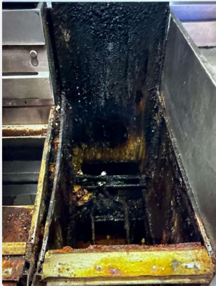
Cuisine cuisson deep fryer kitchen hot equipment unit n°1 photo de l'équipement
