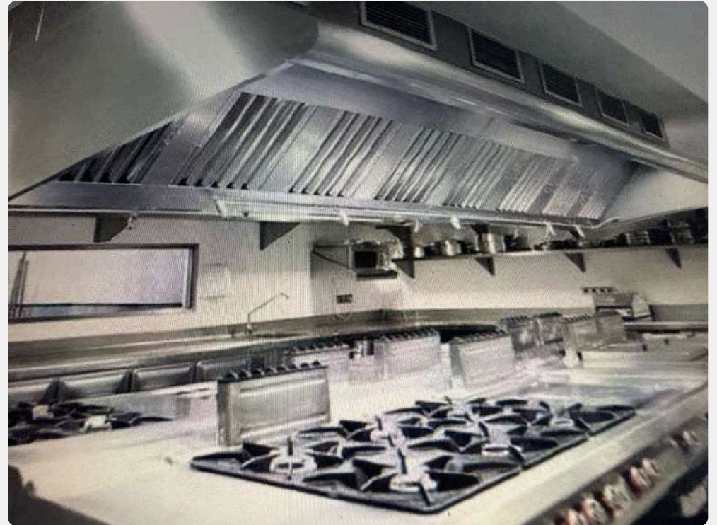
Cuisine cuisson hood kitchen hot equipment unit n°1 photo de l'équipement
